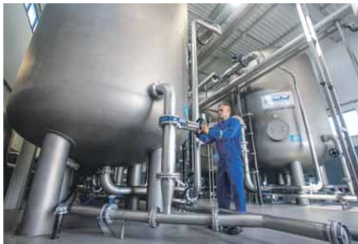
Nowoczesna Stacja Uzdatniania Wody, z której korzystają mieszkańcy m.in. Nowego Sącza i gminy Stary Sącz
